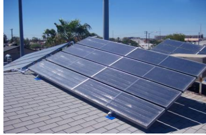
Fig. 5 Solar Thermal Collectors
